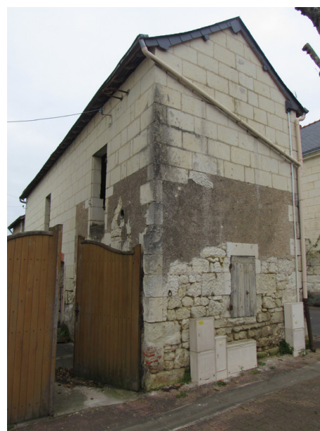
Ce pignon cumule plusieurs désordres. Le bas du mur est rongé par l'humidité, l'enduit de ciment a abîmé les pierres en dessous et l'arrête à gauche est lessivée par la pluie
